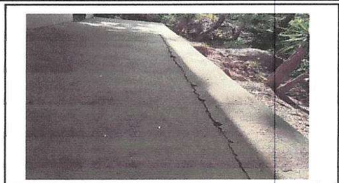
Imagen de la torta de piso de cemento en mal estado rajada y también rajada a lo larga de la unión entre la pared y la torta
