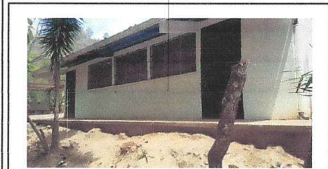
Estado general de las paredes de la Escuela que se desean pintar.
