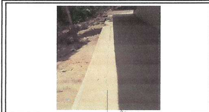
Imagen de muro perimetral en mal estado al cual se le desea agregar 1.5 metros de malla galvanizada para evitar la posible caída de un niño al barrancó.
